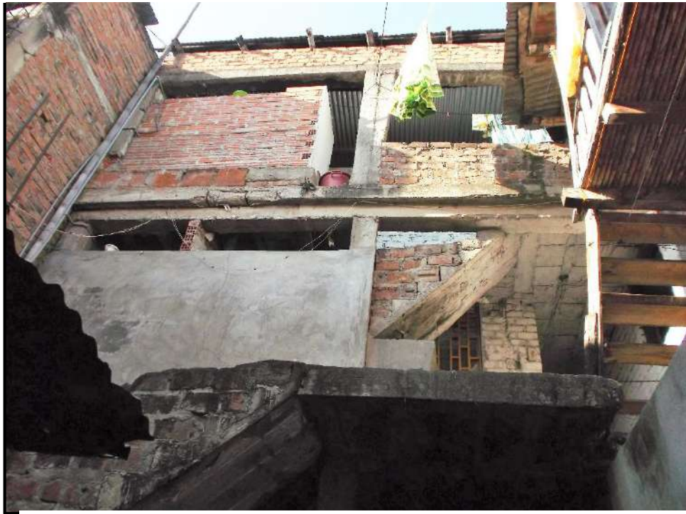
Figura 61. Vista posterior de la vivienda evaluada y de los principales problemas que presenta.
