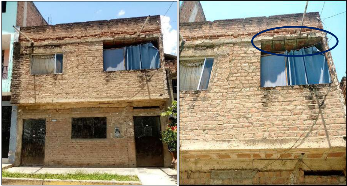
Figura 46 y Figura 47 . Losa aligerada en mal estado, acero de viguetas expuestas a la intemperie.
