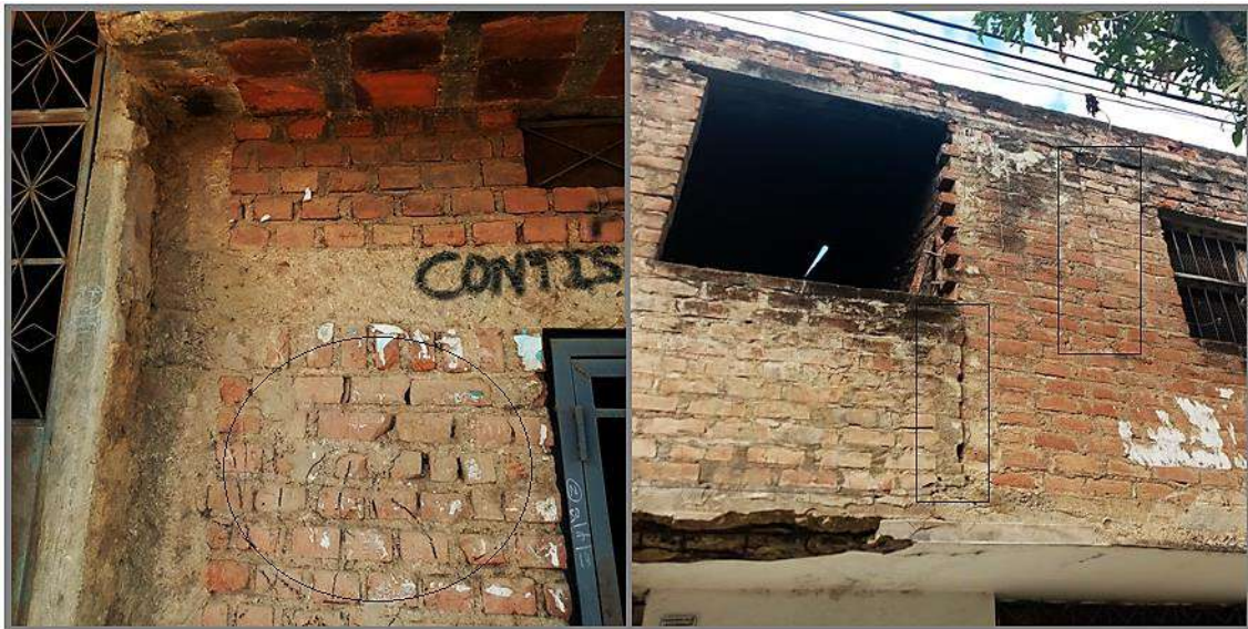
Figura 26. Inadecuado proceso constructivo para asentado de ladrillo y mala trabazon en los muros de albañileria.
