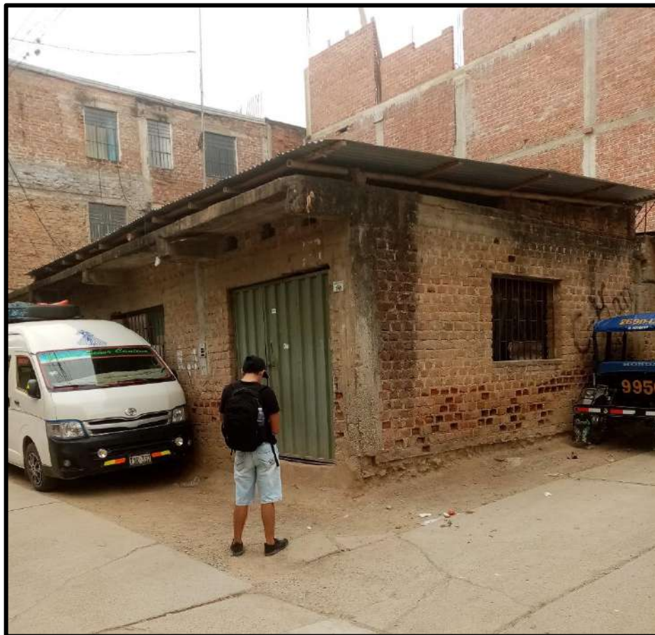
Figura 76. Vivienda de albañilería ubicada en pasaje Chillón, la cual se aprecia en mal estado de conservación.
