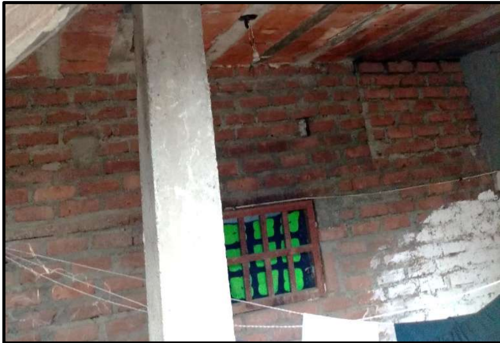
Figura 51. No hay presencia de buen amarre entre las unidades de albañilería.
