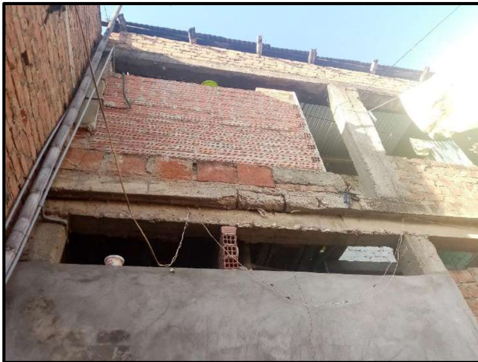
Figura 54. cubierta inestable y en malas condiciones.
