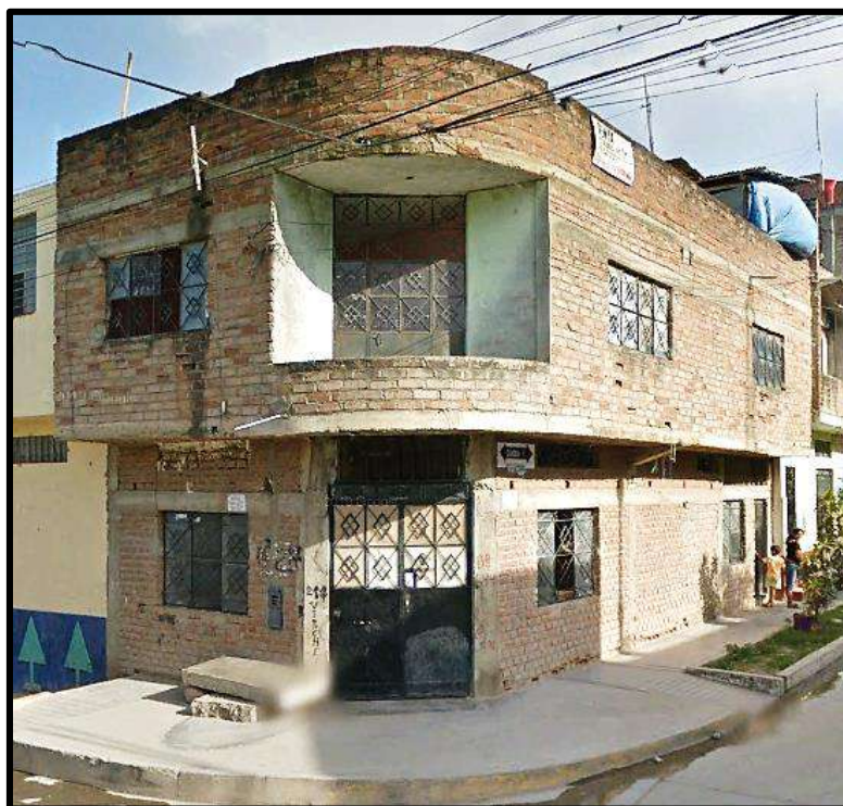
Figura 67. Vivienda de albañilería ubicada en la intersección de la calle Inti Raymi y la calle la Antisuyo, edificación con presencia de Sales y presencia de humedad, ocasionando el deterioro de las unidades de albañilería.
