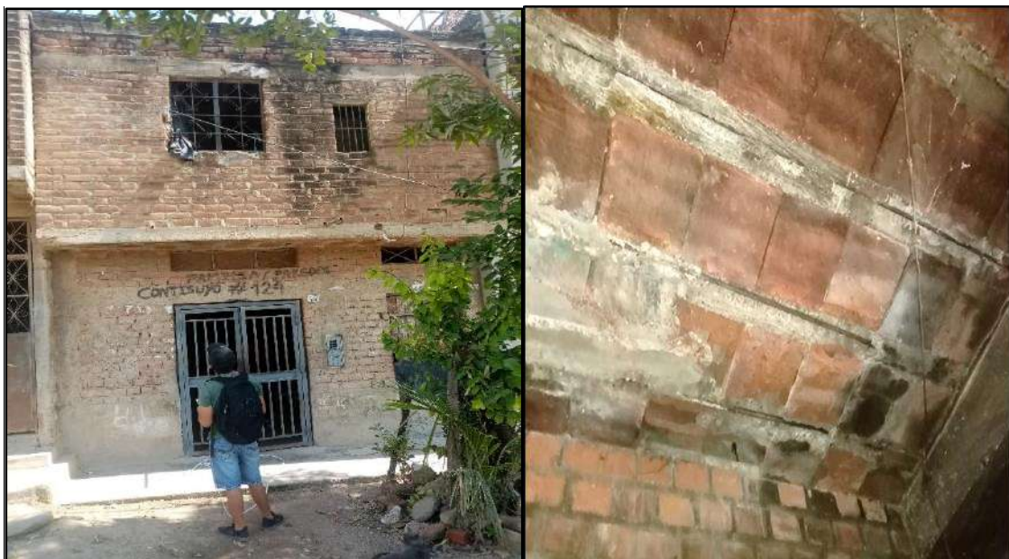
Figura 44 y Figura 45. Identificación de la calidad de mampostería e inspección en interior de vivienda, encontrándose viguetas con exposición de acero y empezándose a corroer.
