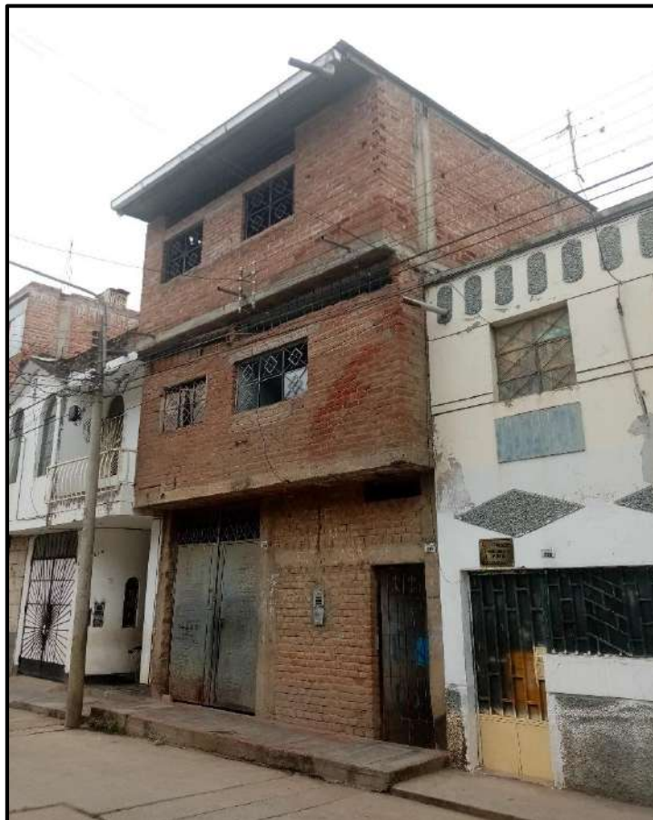
Figura 66. Edificaciones de Albañilería ubicada en el Jr. Chillón. Con deficiencias en su proceso constructivo.
