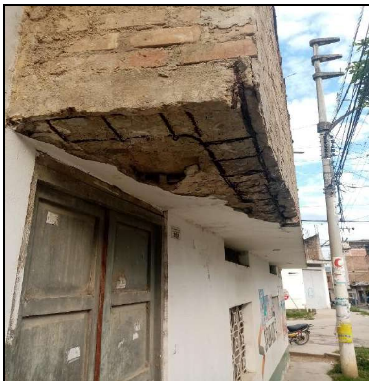
Figura 75. Vivienda de albañilería ubicada en la Calle Atahualpa, Se puede observar la vivienda de albañilería presenta fuerte deterioro en parte del volado en donde se ve el acero corroído, oxidado y desprendimiento del recubrimiento.
