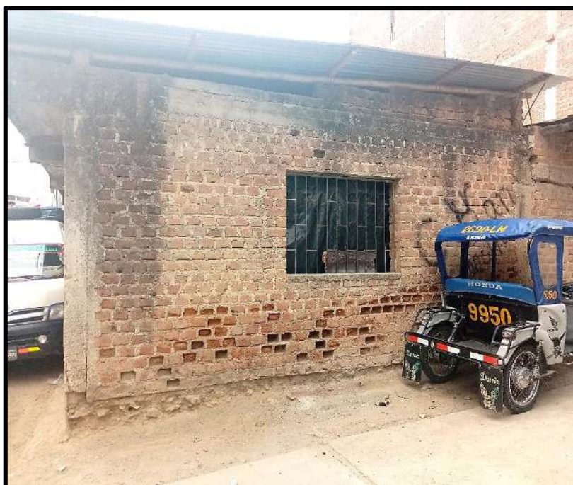
Figura 68. Vivienda de albañilería ubicada en la intersección de la psj. Chillón con el pasaje Chillón, edificación con presencia de Sales y presencia de humedad, ocasionando un fuerte deterioro de las unidades de albañilería.
