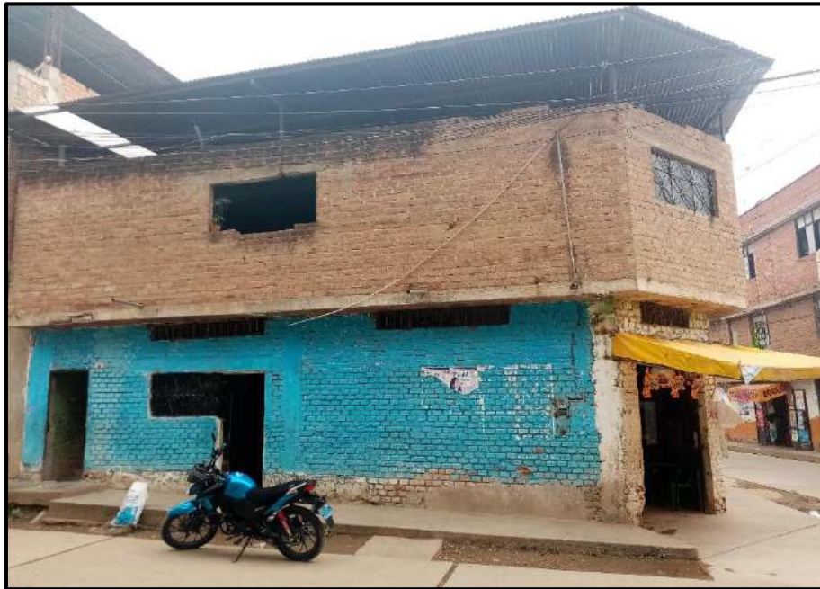
Figura 74. Vivienda de albañilería ubicada en la Calles Cahuide y jr. Chillón, Se puede observar la vivienda de albañilería presenta parapetos sin confinar, deterioro en pequeña parte del volado, deficientes procesos constructivos, etc.
