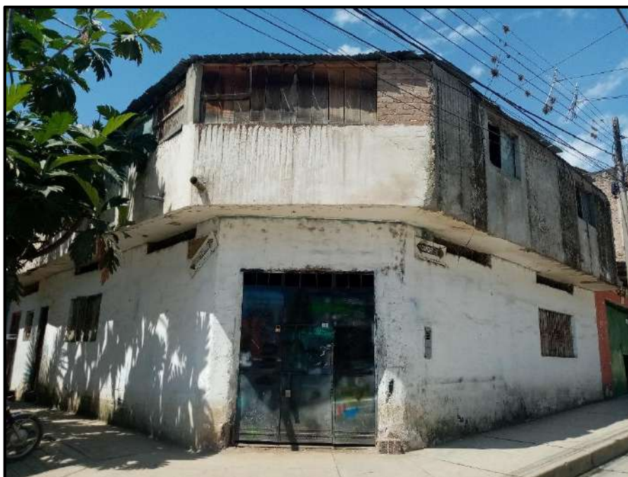
Figura 73. Vivienda de albañilería ubicada entre las calles Cruz de Cajamarca y Coricancha, con cubierta de calaminas en malas condiciones, la cual no tiene una adecuada unión con el muro.
