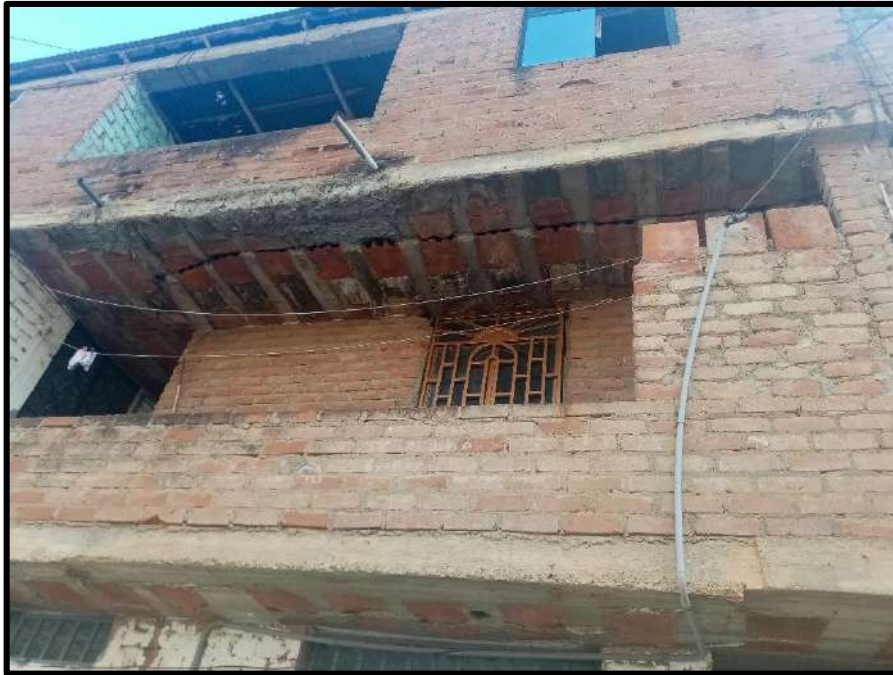
Figura 55. Parapeto mal conectado al resto de la estructura y losa aligera en malas condiciones.
