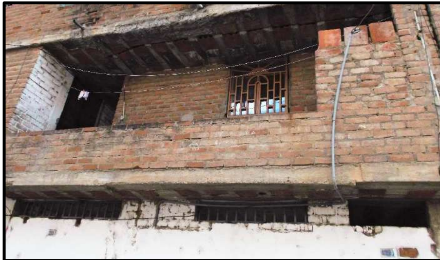
Figura 53. Conexión entre el diafragma y muro no es el adecuado, en uno de los ambientes.
