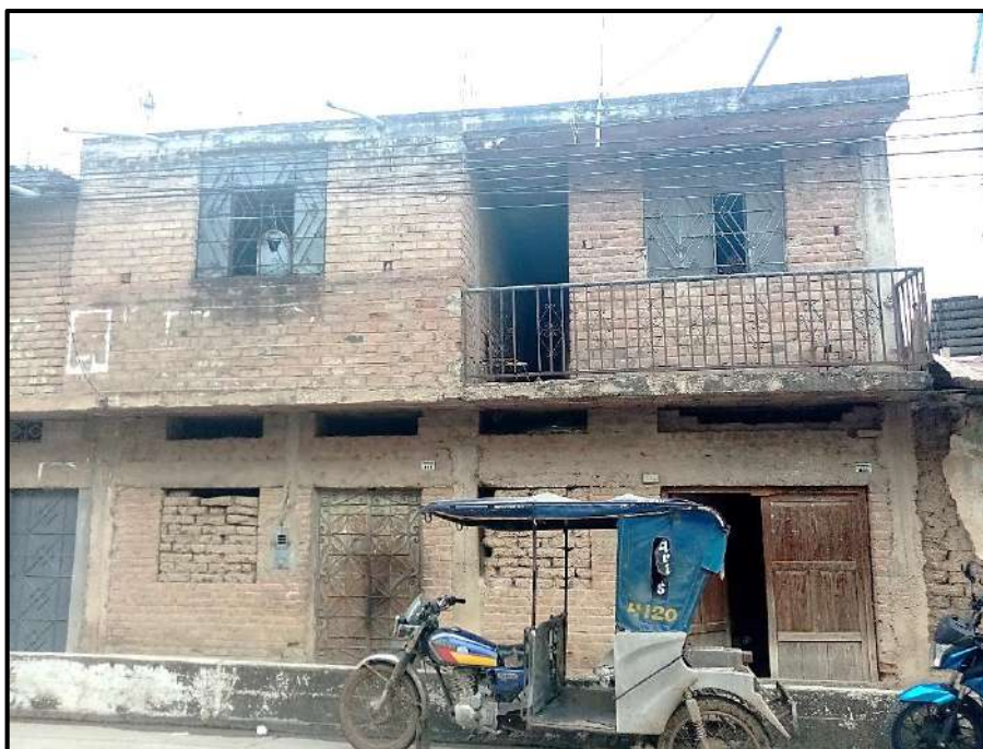
Figura 69. Vivienda de albañilería ubicada en la Calle Pardo Miguel; edificación que presenta mala conexión de diafragma-muro y falta de densidad de muros.
