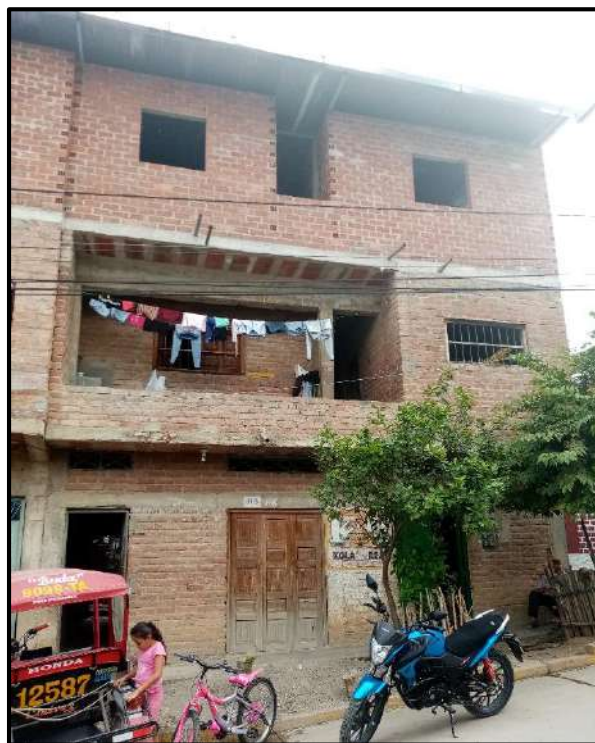
Figura 71. Edificación de albañilería ubicada en la calle 28 de julio; la cual presenta irregularidad de masas del 2 piso respecto al 1 piso.
