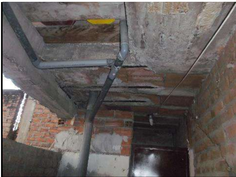
Figura 58. Muro portante agrietado y mala colocación de tuberías sanitarias.
