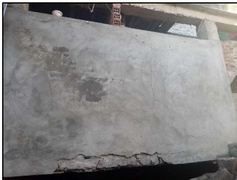
Figura 60. tabique fisurado y parte de losa aligera en muy malas condiciones debido exposición de acero de las viguetas y reducción de su sección de acero producto de la oxidación.
