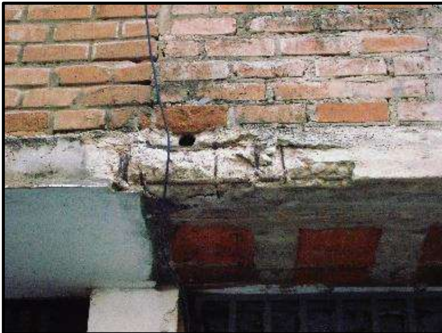
Figura 56. Acero de viga chata empezándose a corroerse y mala trabazón entre las unidades de albañilería.
