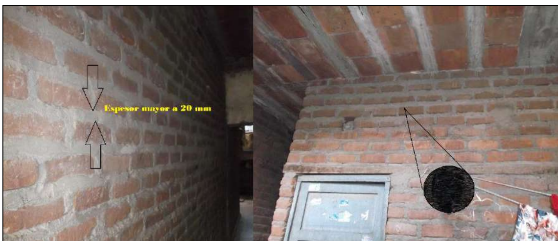
Figura 13. Muros portantes con espesor de junta inadecuado.
