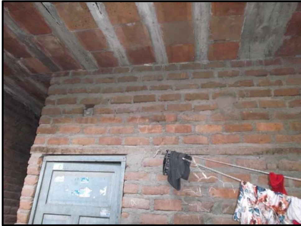
Figura 52. Mortero de mala calidad con espesor de 20-40mm.
