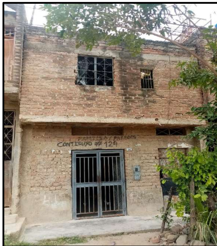
Figura 65. Edificaciones de Albañilería ubicada en la calle Constituyo. Con mal proceso constructivo de asentado de ladrillos, ladrillos artesanales de regular calidad y estado de mortero no homogéneo.
