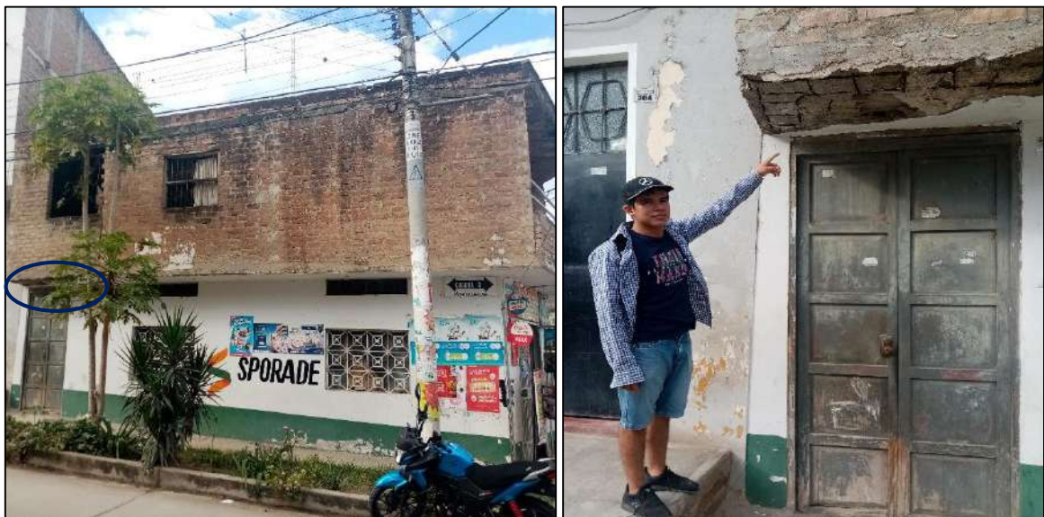
Figura 48 y Figura 49 . Volado en estado deteriorado, oxidación de acero de viga chata y desprendimiento de concreto, además mal confinamiento en muros de volado.
