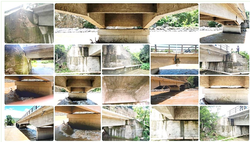
Eflorescencia en vigas, estribos y diafragmas inferiores de la subestructura del Puente Tamborapa.
